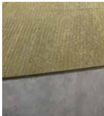
WOLF MIWO AUF STAHLBETONDECKE
